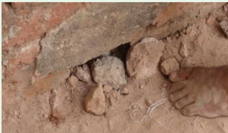
Bojājumi pagodas jumta hidroizolācijā Baganā, Mjanma, 2016. Fotoattēls: Eugénie Crété.
