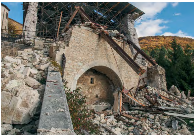
Некаркасна конструкція, пошкоджена землетрусом, Італія, 2017. Світлина: Ейсуке Нішикава
