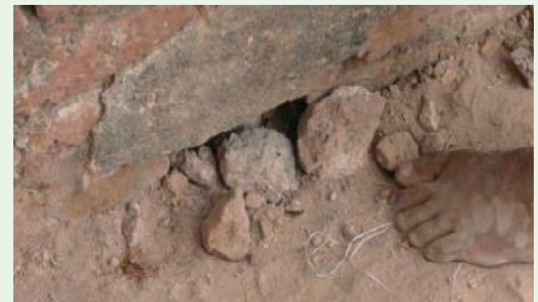
Отвори у системі гідроізоляції покрівлі пагоди, Баган, М'янма, 2016. Світлина: Ежені Крете
