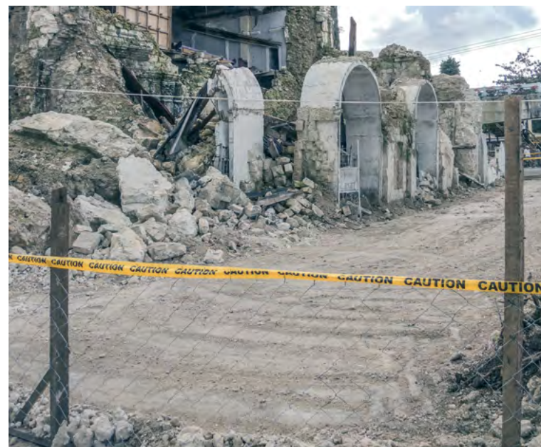
Загорожі й сигнальні стрічки попереджають про небезпеку та блокують доступ до пошкодженої церкви на Філіппінах, 2013. Світлина: Апарна Тандон, ICCROM
