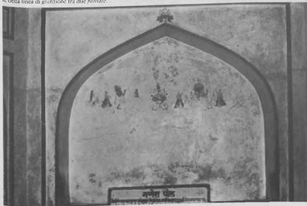
Tav. 41 - Fort Amber (Rajasthan). La decorazione pittorica della nicchia mostra, circa a metà altezza, la traccia orizzontale della linea di giunzione fra due putate .
