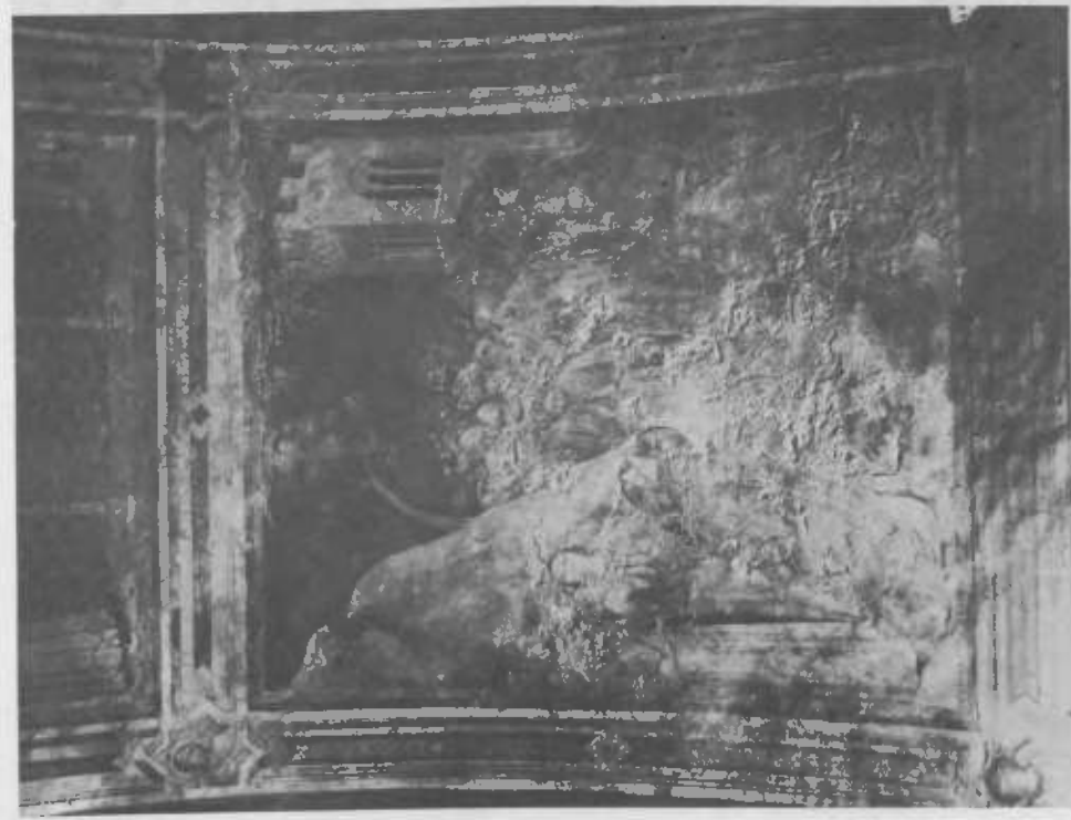
Tav. 124 - Assisi, Cappella San Martino di Simone Martini. Alterazioni dovute all'umidità; distacco e polverizzazione della pellicola pittorica.
