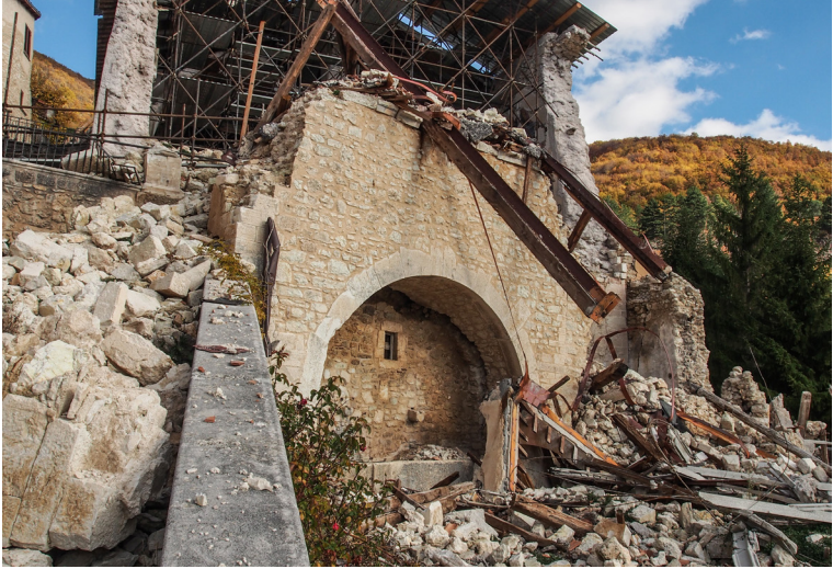
منشأ حوائط حاملة متضرر جراء زلزال في إيطاليا، ٢٠١٧. الصورة: إيسكي نيشكاوا.
